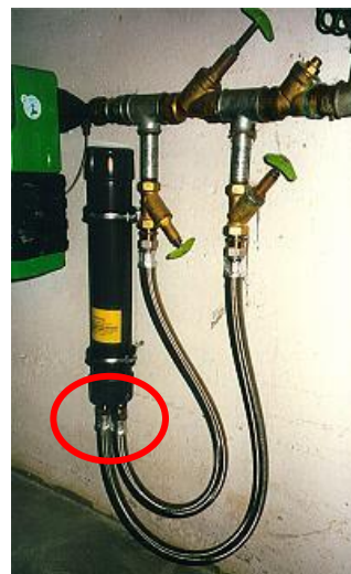
L'Activateur installé sous de la conduite d'Eau: les branchements doivent être dirigés vers le bas
